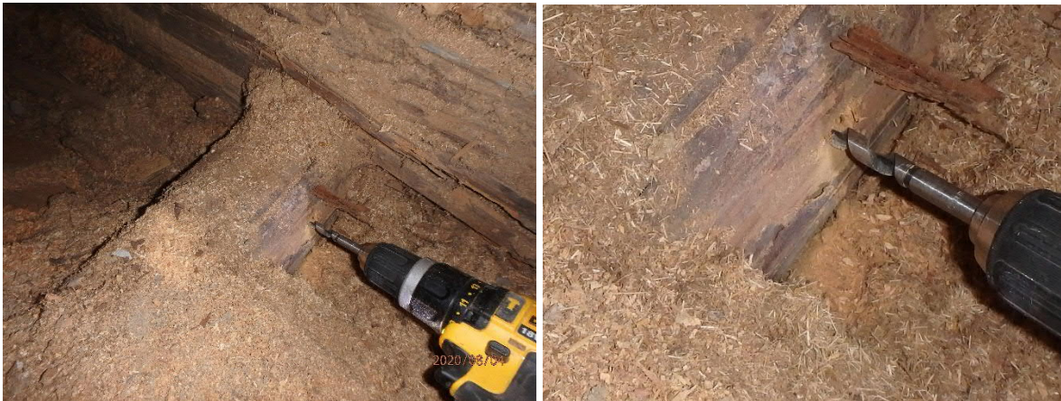
Kuva 9. Keittiön vaurioituneeseen seinään liittyvän alapohjan kannatinpalkit olivat pinnaltaan lähes ehjiä, mutta porauksen avulla niiden sisäosasta todettiin hyönteisvaurioita (poranterä nostaa vain jauhoa).
