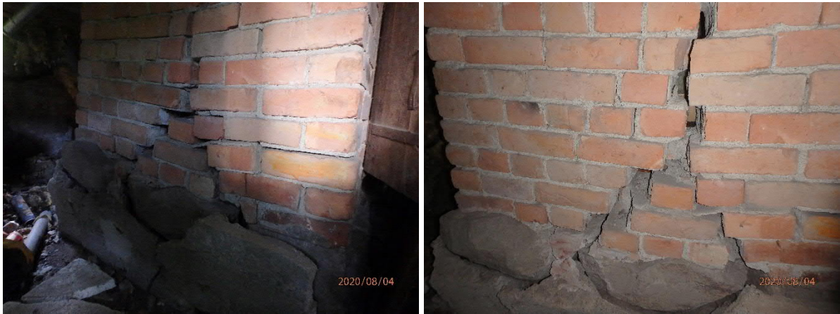
Kuva 3. Piippuperustus ja piipun alaosa on haljennut.
