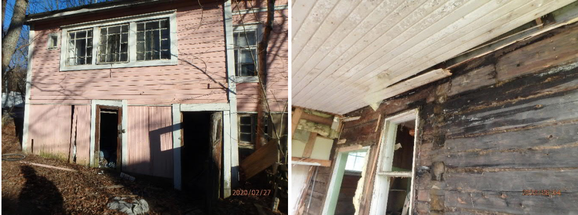
Kuva 12. Kuistin rakenteet oli jo aiemmassa maakuntamuseon selvityksessä todettu korjauskelvottomiksi. Nyt havaittu eteisen ja huoneen välisen ristinurkan kohdalla oleva kattovuoto on vaurioittanut myös kuistin yläpohjaa.
