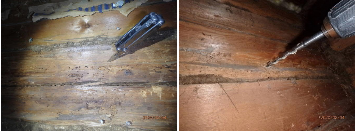
Kuva 8. Väliseinähirsissä lahoalueiden vieressä todettiin hyönteisten aiheuttamaa turmeltumista. Pintojen vaurioitumisen ja näkyvien lentoaukkojen perusteella kyseessä voi olla Tupajumin tai Kuolemanhollon yhdyskunnista.
