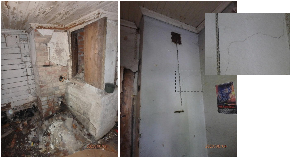
Kuva 4. Hormiperustusten liikkuminen on aiheuttanut vaurioitumisen myös kellaritilassa olevaan piippuun (vasemmalla) ja 1. kerroksen savuhormiin (oikealla).
