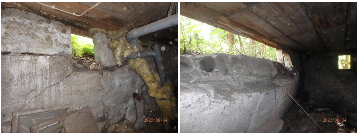
Kuva 2. Pohjoisjulkisivun alapuolinen betoniperustus on kaatunut ja poikittaisen hirsiseinän linjalla ollut kivipilari on kallistunut pois seinän alta.
